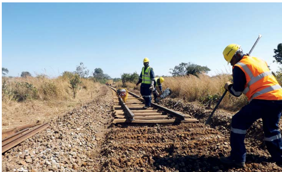
Voie ferrée de la SNCC dans l'ex-Province du Katanga en pleine réhabilitation.
